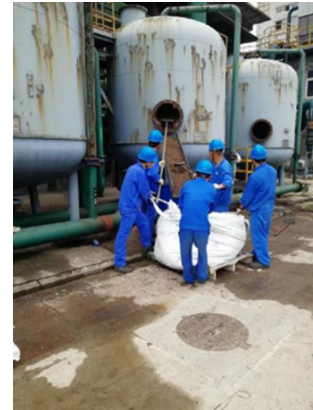
砂过滤器装填
