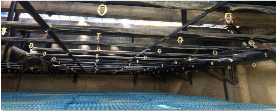
冷却水塔喷嘴的定期维护
