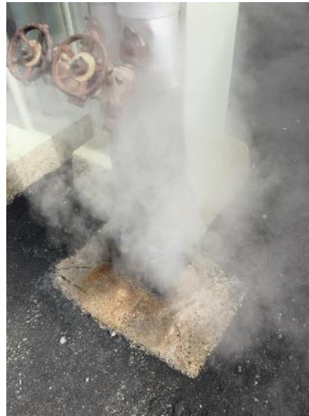
蒸汽疏水阀泄露检查
